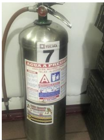
Fotos. Inspección a Extintores
